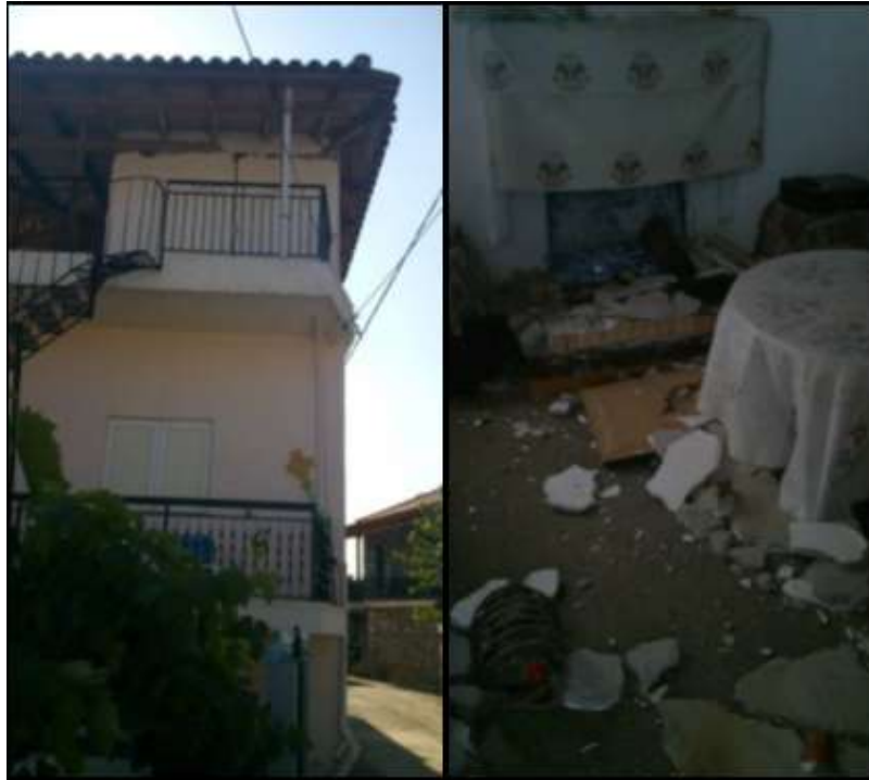
Σχήμα 2.5 Κτήριο στη Δρυμαία. Κρίθηκε ακατάλληλο για χρήση ( www.oasp.gr ).
