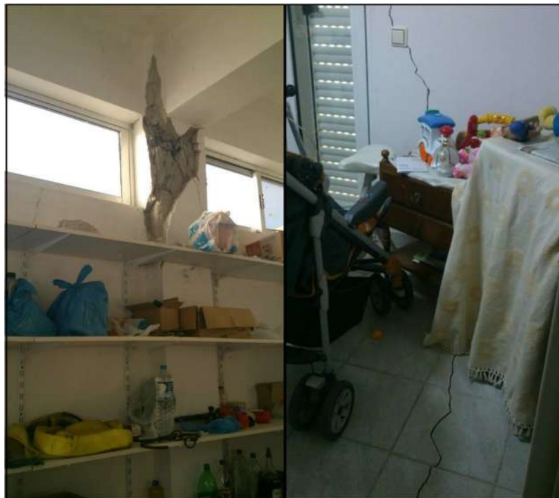
Σχήμα 2.8 Βλάβες σε κατοικία με σκελετό από οπλισμένο σκυρόδεμα ( www.oasp.gr ).
