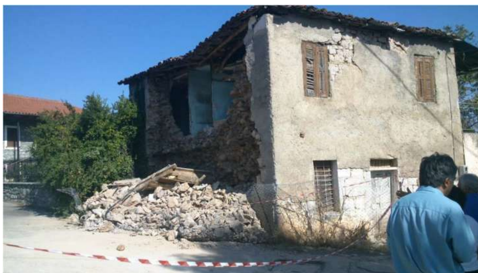
Σχήμα 2.6 Μερική κατάρρευση ακατοίκητου κτηρίου ( www.oasp.gr ).
