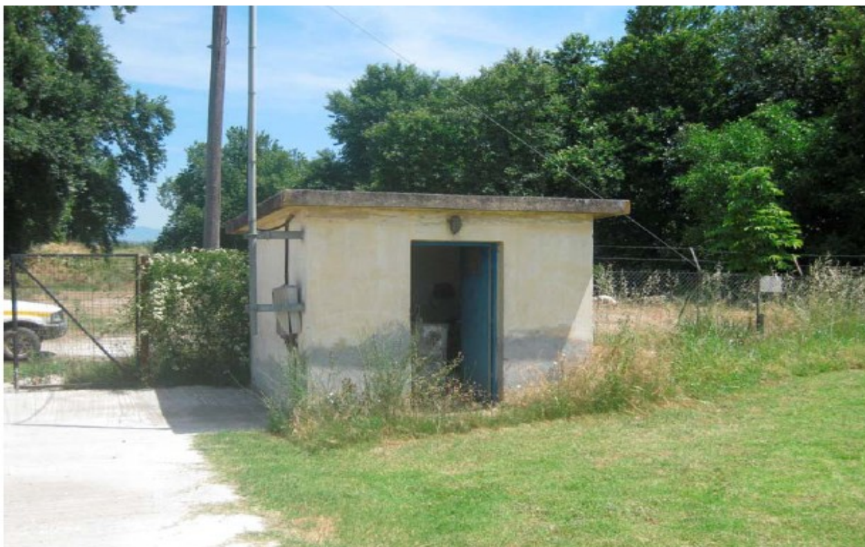
Φωτογραφία 5: Υδρευτική γεώτρηση Τοπικού Διαμερίσματος Γερακαρούς
