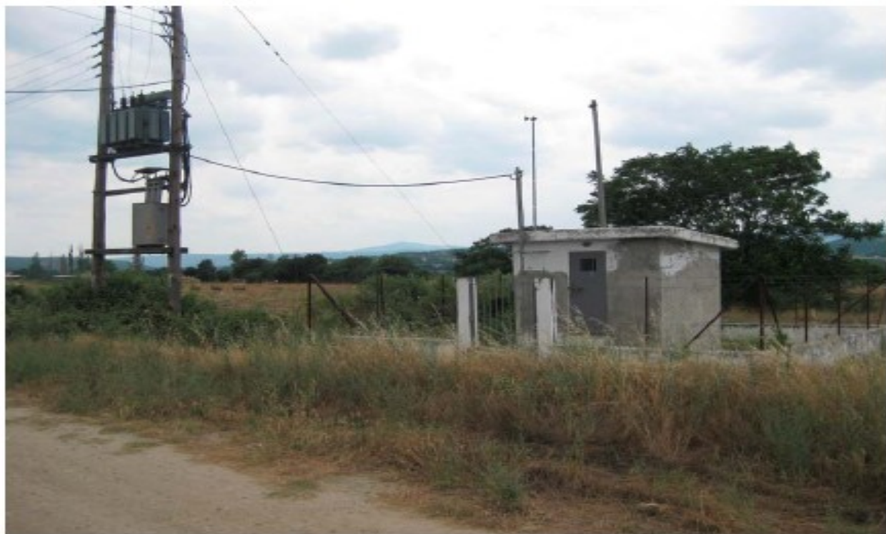
Φωτογραφία 8: Υδρευτική γεώτρηση Γ.9 Τοπικού Διαμερίσματος Λαγκαδικίου
