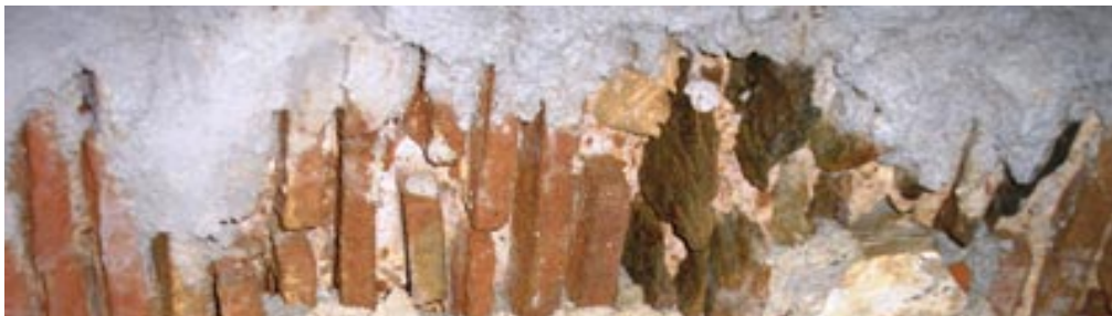
Εικόνα 11: Ενδείξεις ενίσχυσης τοιχοποιίας.
