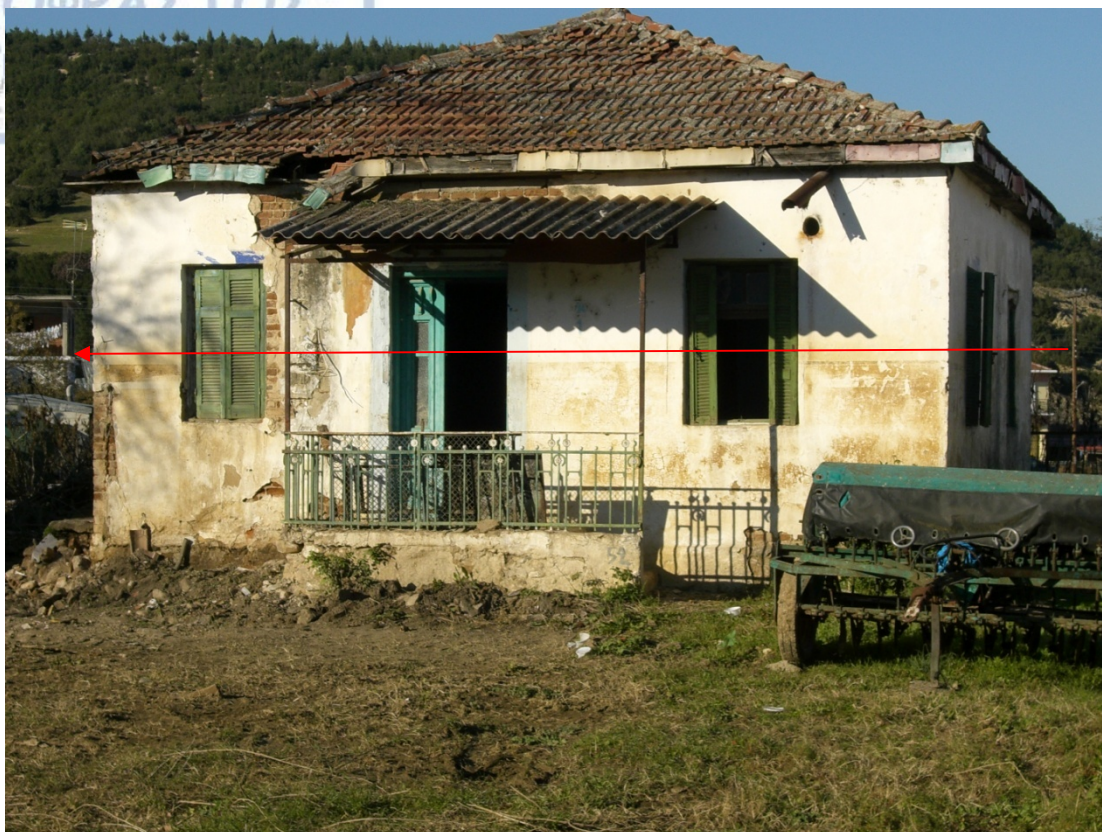
Εικόνα 18 ύψος πλημμύρας σε οίκημα στη χαμηλή ζώνη του χωριού
