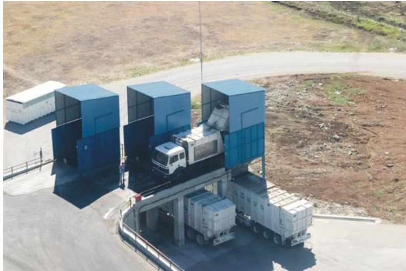
Εικ.8: Σταθμός μεταφόρτωσης απορριμμάτων Αμμοχώστου(Πηγή: ΚΥΠΕ can.org.cy )
