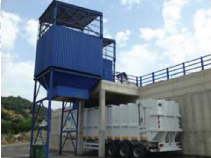
Εικ.15:Σταθμός μεταφόρτωσης απορριμμάτων(Πηγή: www.argolike-seidhseis.gr )
