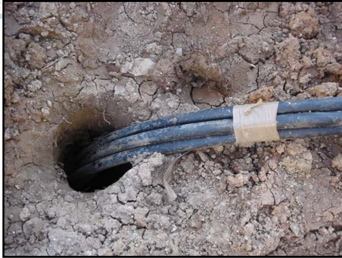
Εικόνα 18. Γεωθερμικοί σωλήνες-εναλλάκτες θερμότητας (φωτογραφία 2 η ).
