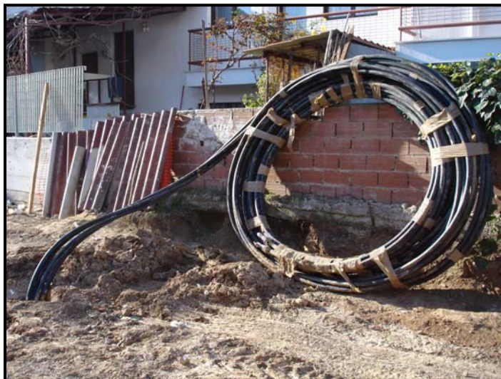
Εικόνα 19. Γεωθερμικοί σωλήνες-εναλλάκτες θερμότητας (φωτογραφία 3 η ).
