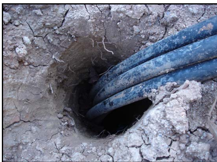
Εικόνα 17. Γεωθερμικοί σωλήνες-εναλλάκτες θερμότητας (φωτογραφία 1").
