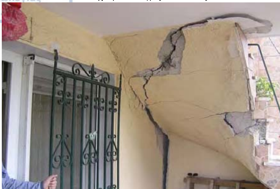
Φωτογραφία 1. Ρωγμές σε κατοικίες.
