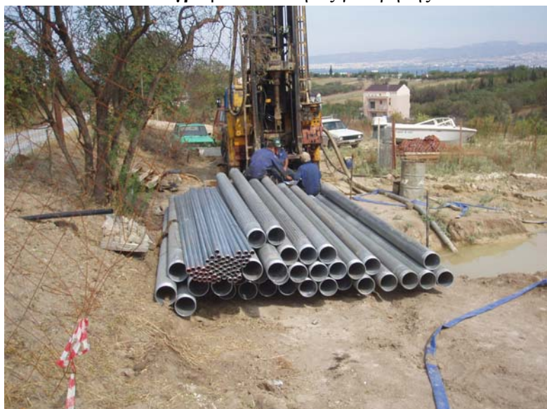
Φωτογραφία 9. Σωλήνες γεώτρησης.
