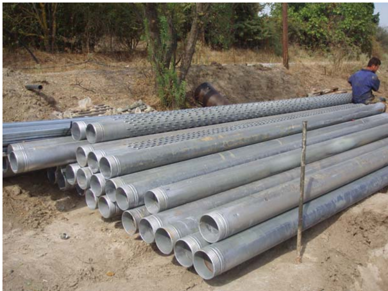
Φωτογραφία 8. Σωλήνες γεώτρησης.
