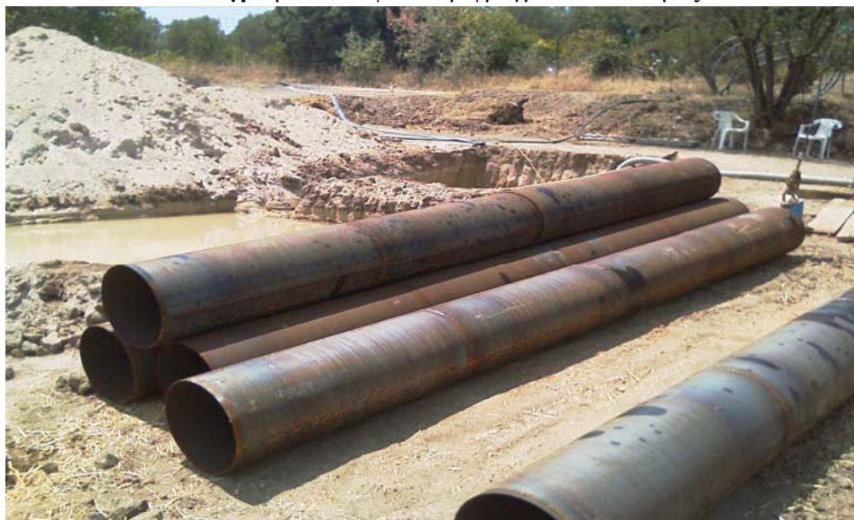
Φωτογραφία 4. Τυφλοί περιφραγματικοί σωλήνες.
