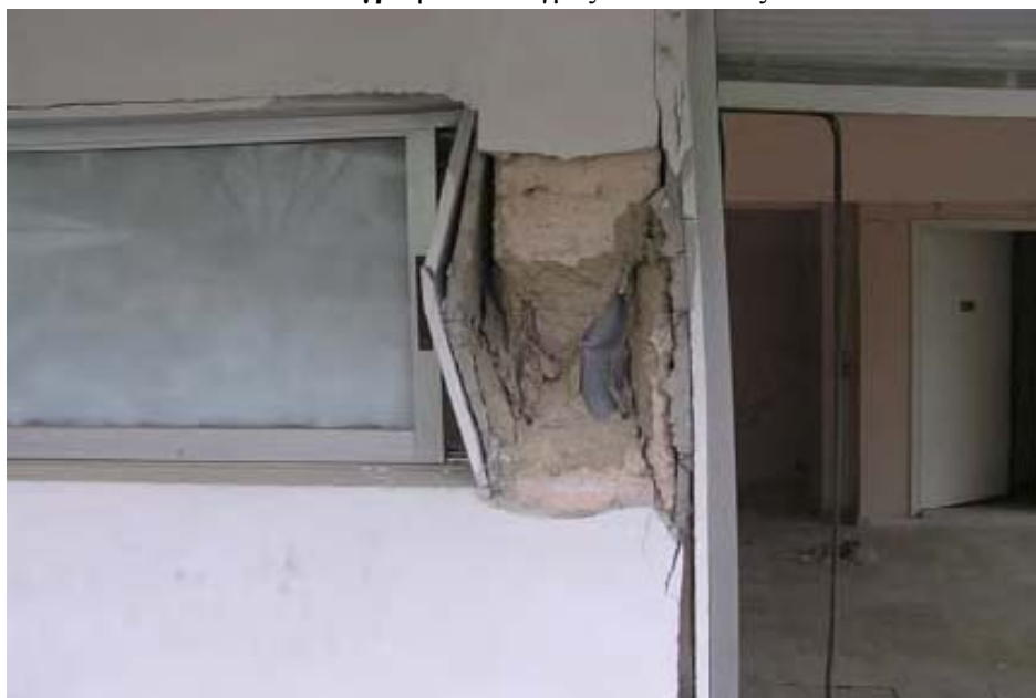
Φωτογραφία 2. Ρωγμές σε κατοικίες.
