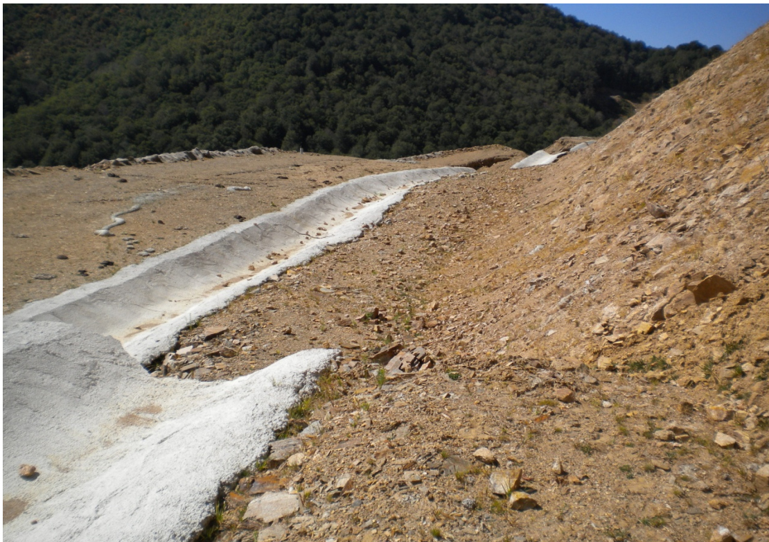
Φωτογραφία . Πλαγιο-οριζόντια μετατόπιση ενός τμήματος της τάφρου αποστράγγισης λόγω της ολίσθησης.
