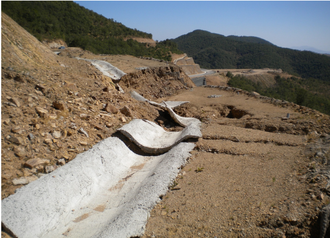
Φωτογραφία 6.6. Διακρίνονται οι εγκάρσιες ως προς το πρηνές ρωγματώσεις .
