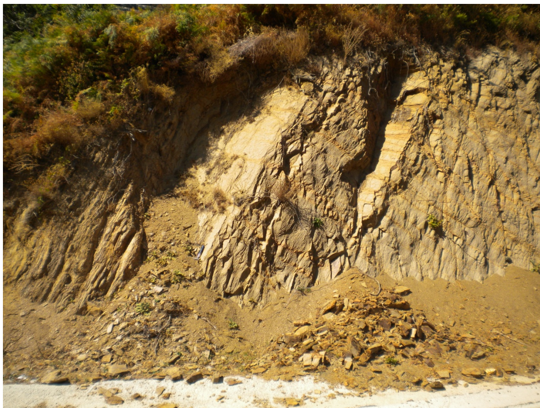
Φωτογραφία 5.5. Σφηνοειδείς αστοχίες σε αποσαθρωμένη σχιστώδη γνευσιακή βραχώμαζα της περιοχής μελέτης. GSI=25-40
