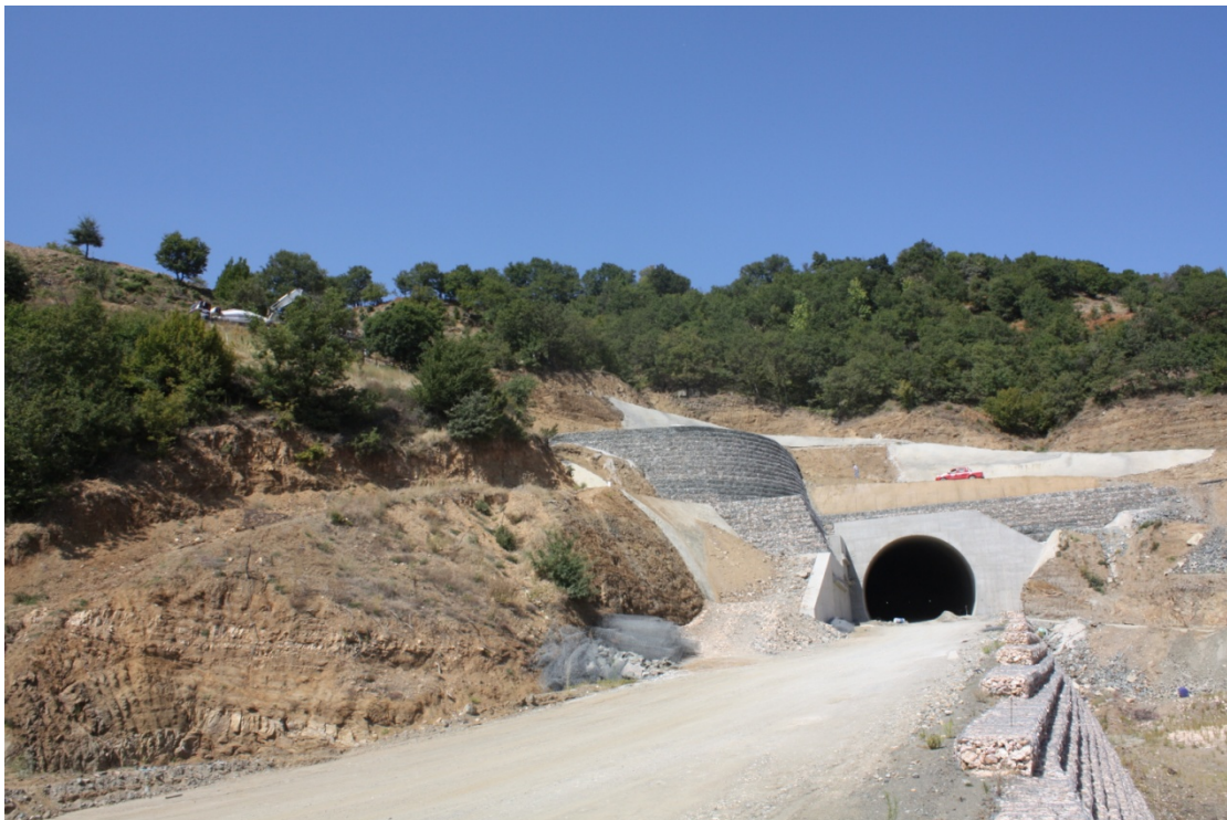
Φωτογραφία . Σήραγγα Νυμφαίας (αρχή του άξονα 75). Στο αριστερό πρानές αντιμετωπίστηκαν προβλήματα ευστάθειας.
