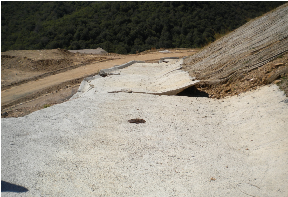
Φωτογραφία . Θραύση της τάφρου παροχέτευσης στο O28.
