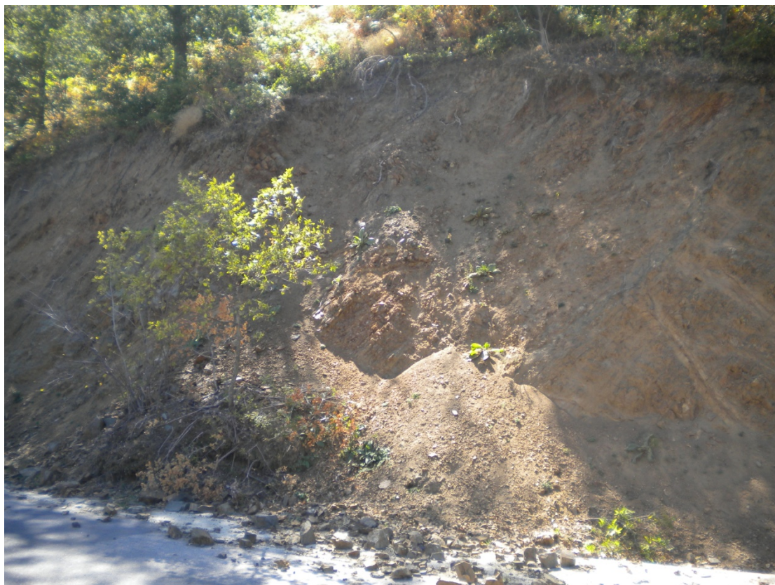
Φωτογραφία . Ολίσθηση γαιωδών
