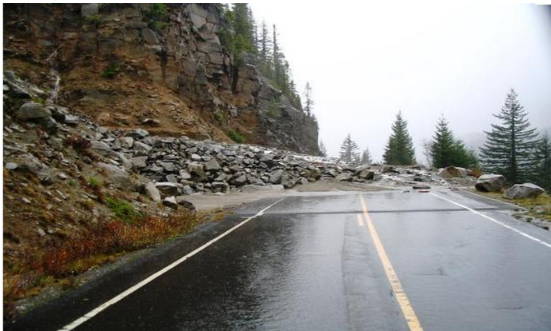
Φωτογραφία 2.1. Κατολίσθηση στην Εθνική Οδό Τριπόλεως-Αρχαίας Ολυμπίας.
