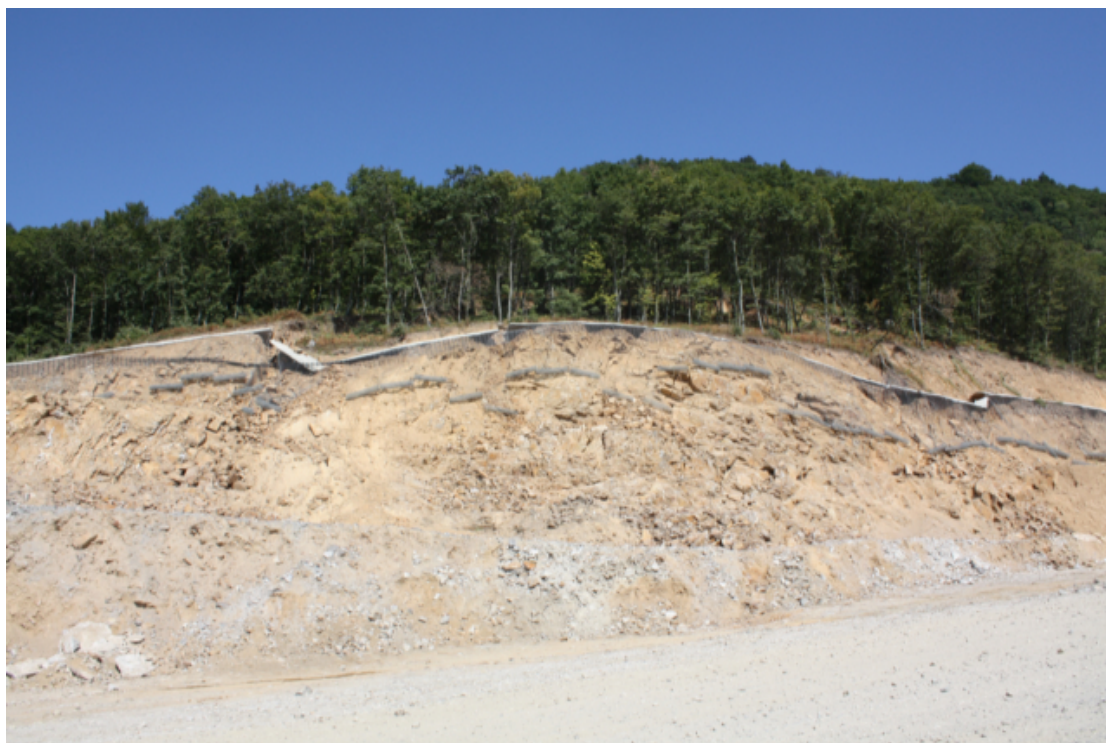
Φωτογραφία 6.2. Μετά την κατολίσθηση του 2010
