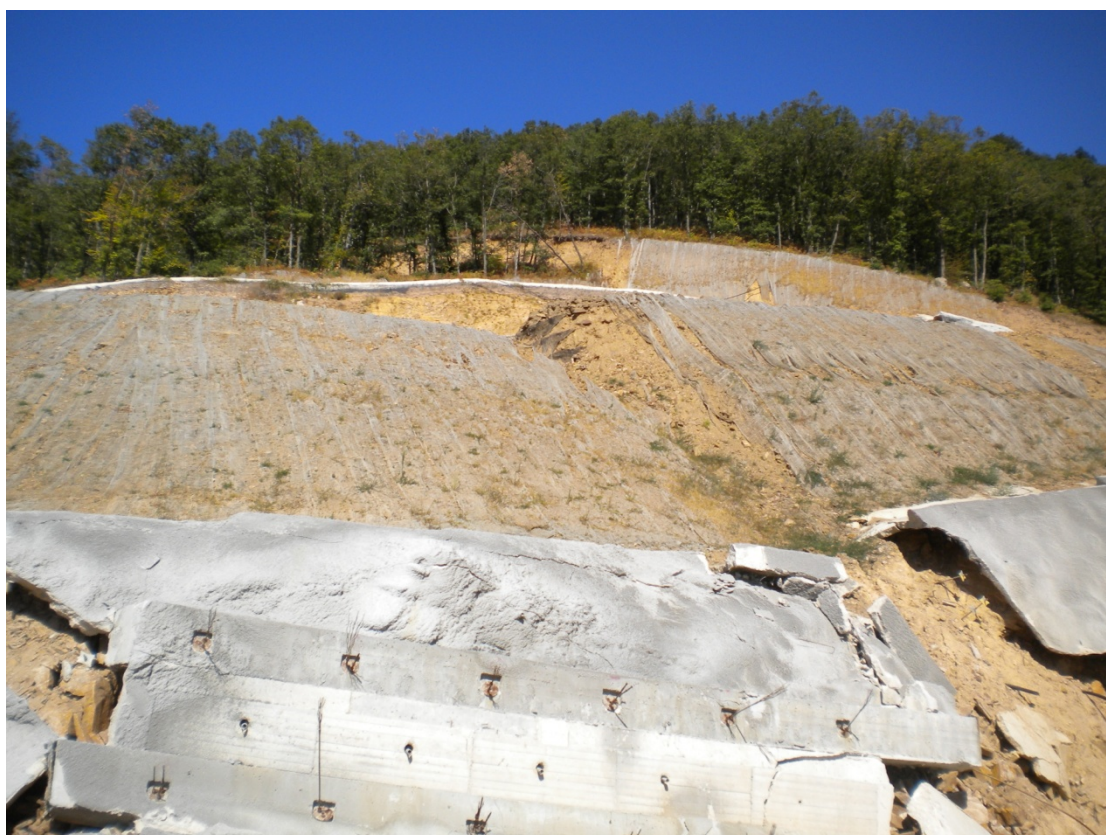
Φωτογραφία 6.3. Μετά την κατολίσθηση του 2012
