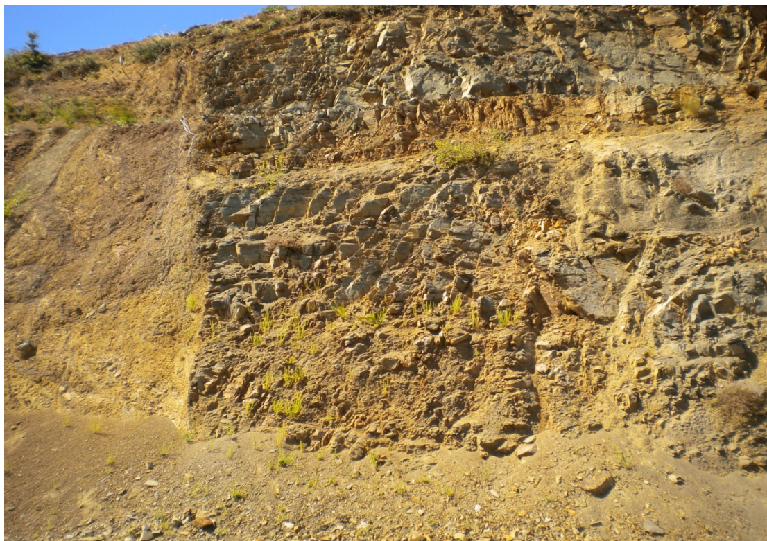
Φωτογραφία . Υγιής γνευσιακή βραχώμαζα (δεξιά) και διαμτημένη γνευσιακή βραχώμαζα (αριστερά).
