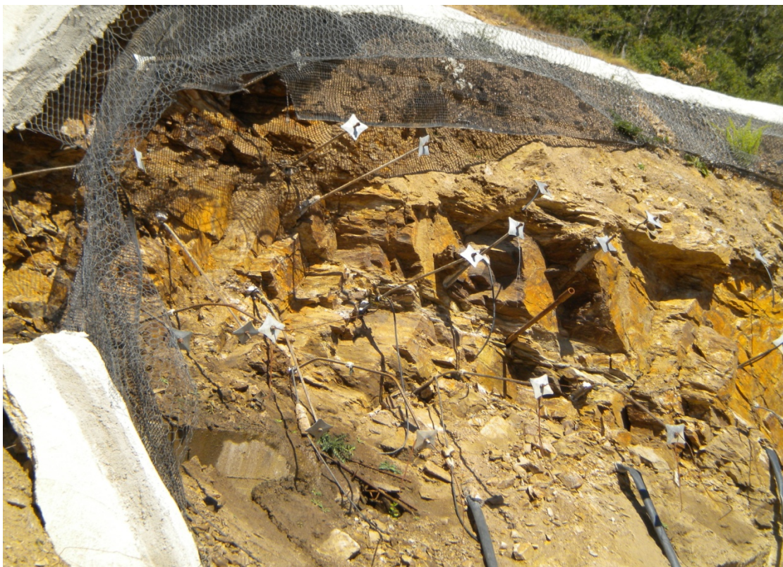
Φωτογραφία . Τα αγκύρια που είχαν τοποθετηθεί προ της κατολίσθησης έχουν διαρρεύσει.
