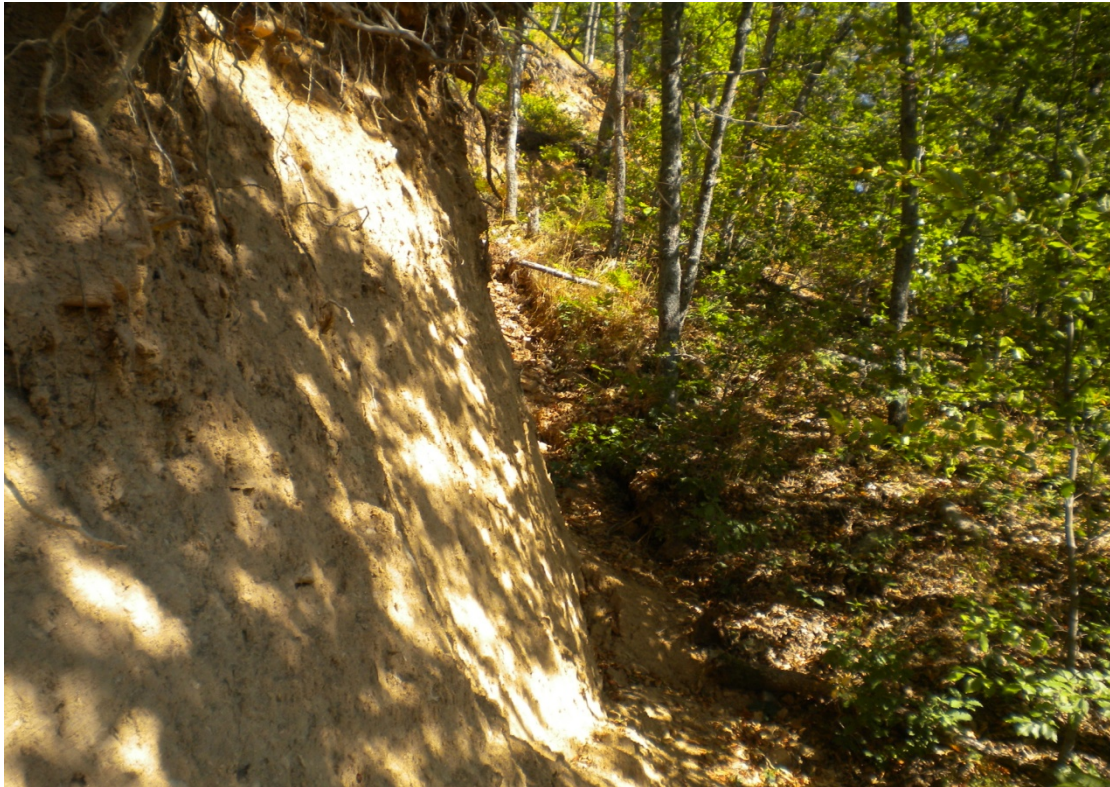
Φωτογραφία . Η μετατόπιση που προκλήθηκε από την ολίσθηση στο Ο28. Η επιφάνεια αυτή αποτελεί επιφάνεια ρήγματος διεύθυνσης Α-Δ (παραιοριζόντια ζώνη διάτμησης). Έχει GSI=5-7 και αντοχή άρρηκτου βράχου 5 Μpa.
