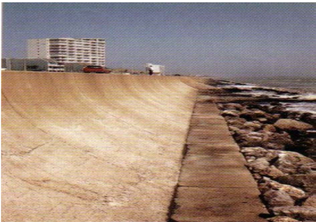
Εικόνα 3.7: Τοίχος προστασίας ύψους 5,5 m από οπλισμένο σκυρόδεμα στο Galveston του Τέξας. Είναι εμφανές ότι δίπλα στον τοίχο προς τη μεριά της θάλασσας δεν υπάρχει καθόλου άμμος. (URL 6 )
