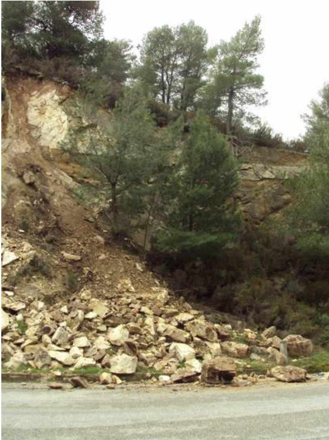
ΦΩΤΟΓΡΑΦΙΑ 30: ΕΜΦΑΝΗΣ ΕΙΚΟΝΑ ΤΗΣ ΚΑΤΟΛΙΣΘΗΣΗΣ ΤΕΜΑΧΩΝ ΠΕΤΡΩΜΑΤΟΣ
