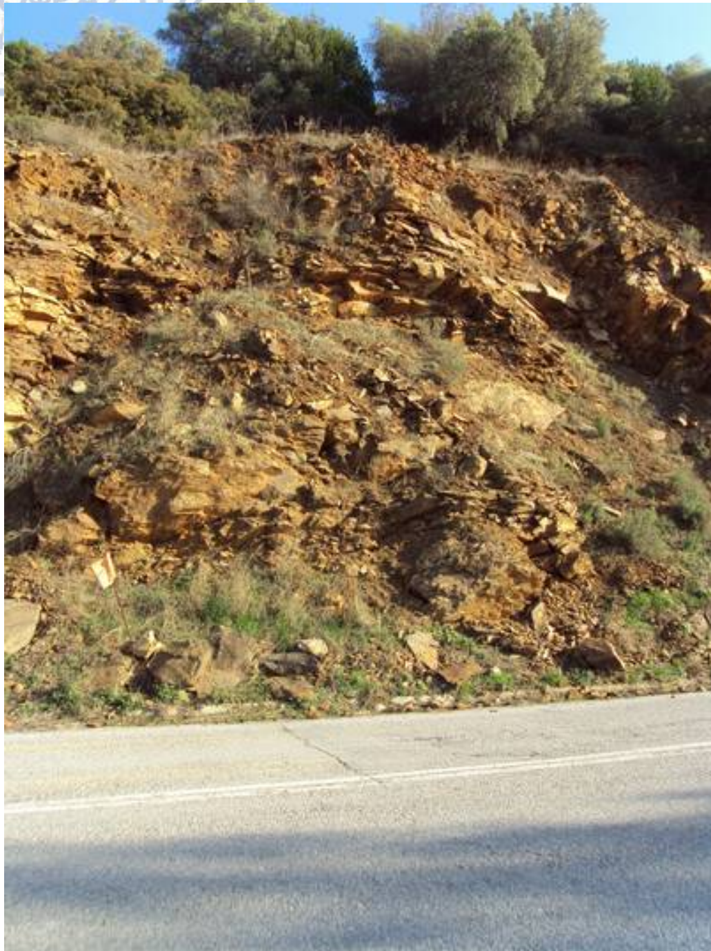
ΦΩΤΟΓΡΑΦΙΑ 45: ΠΑΡΑΤΗΡΕΙΤΑΙ Η ΠΛΗΡΗΣ ΚΑΤΑΘΛΙΨΗ ΤΟΥ ΠΕΤΡΩΜΑΤΟΣ.ΛΟΓΩ ΤΗΣ ΟΞΕΙΔΩΣΗΣ ΤΟΥ ΕΧΕΙ ΥΠΟΣΤΕΙ ΜΕΓΑΛΗ ΔΙΑΒΡΩΣΗ.
