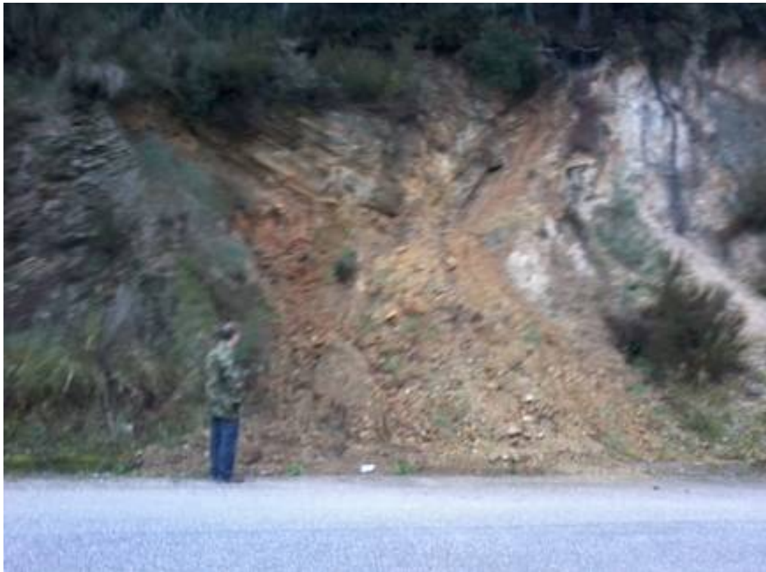
ΦΩΤΟΓΡΑΦΙΑ 22: ΚΑΤΑΠΤΩΣΗ-ΚΑΤΟΛΙΣΘΗΣΗ ΥΛΙΚΟΥ
