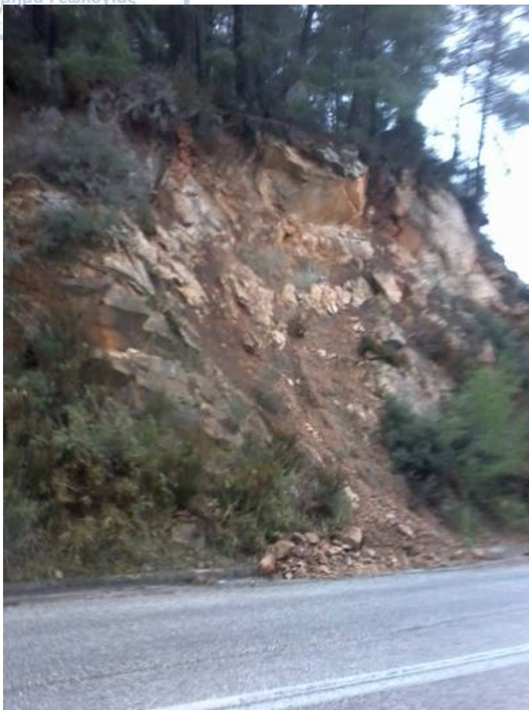
ΦΩΤΟΓΡΑΦΙΑ 21: ΚΑΤΑΠΤΩΣΗ-ΚΑΤΟΛΙΣΘΗΣΗ ΛΟΓΩ ΦΥΣΙΚΩΝ ΔΙΕΡΓΑΣΙΩΝ ΠΟΥ ΕΠΙΔΡΟΥΝ ΠΑΝΩ ΣΕ ΑΥΤΟ.
