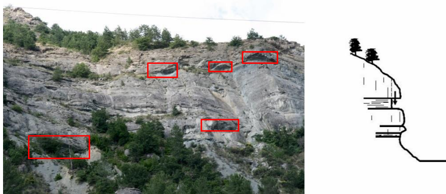
Σχήμα 1.3 Αποτύπωση χαρακτηριστικών δομών υποσκαφής κατά μήκος της επιφάνειας στρώσης στο μέτωπο του πρανού (αριστερά) και σχηματική απόδοση του μηχανισμού δημιουργίας των δομών (δεξιά, (Wyllie, 2015))
