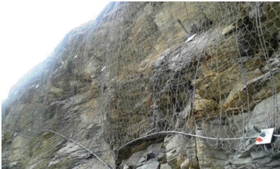
Εικόνα 14: Μεταλλικά πλέγματα συγκράτησης των ασθενών βραχωδών τεμαχών. (Πηγή: www.asate.gr )
