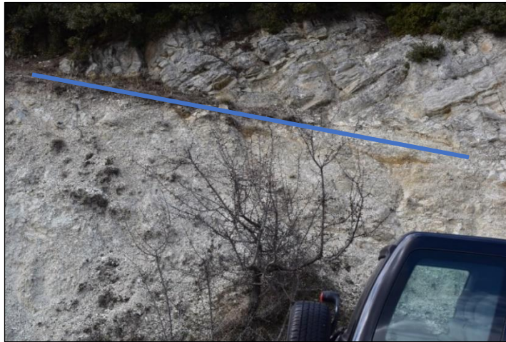
Εικόνα 31: Ζώνη διάτμησης με χαρακτηριστική επίδραση μωλυνιτώσης, (πάνω) μετρίως αποσαθρωμένος (III) γρανιτογενεύσιος, GSI 35-45.
