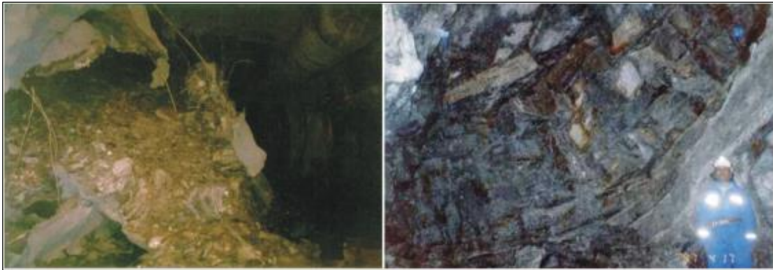
Εικόνα 8: Προβλήματα ευστάθειας της εκσκαφής, αστοχία μετά την εφαρμογή μέτρων υποστήριξης (αριστερά), ασυνέχειες γνευσιακής βραχομάζας (δεξιά).
