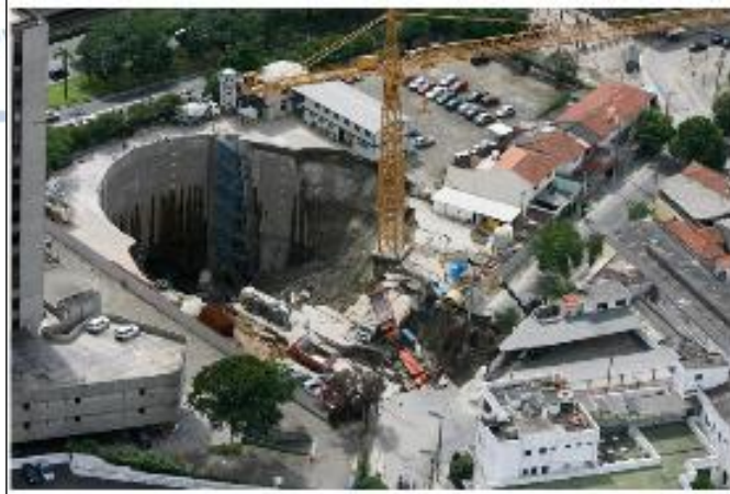
Εικόνα 12: Αστοχία σταθμού του μετρό στο São Paulo.
