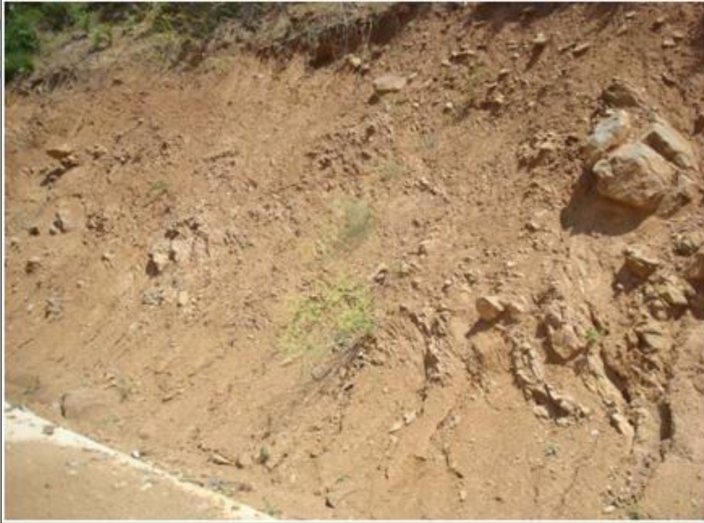
Εικόνα 6: Πλήρως αποσαθρωμένη γνευσιακή βραχομάζα.
