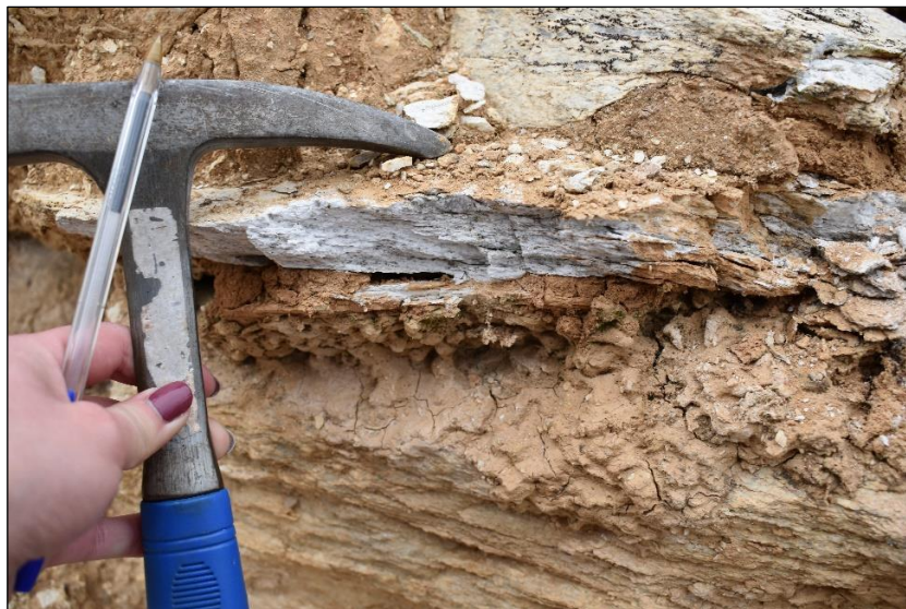
Εικόνα 14: Υψηλά αποσαθρωμένους (IV) γνευσιογρανίτης, χαρακτηρίζεται από GSI 15-25 στην περιοχή έρευνας.
