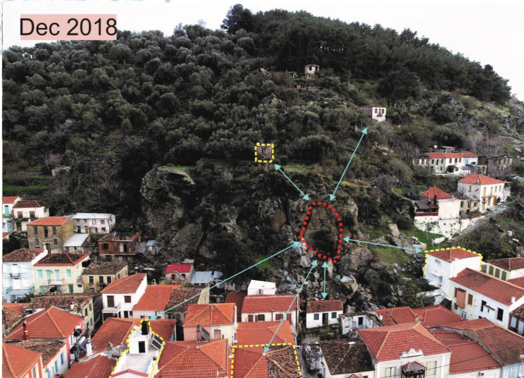
Εικόνα 44: Άποψη του πρανούς από τα Β, μετά την αστοχία, Δεκέμβριος 2018
