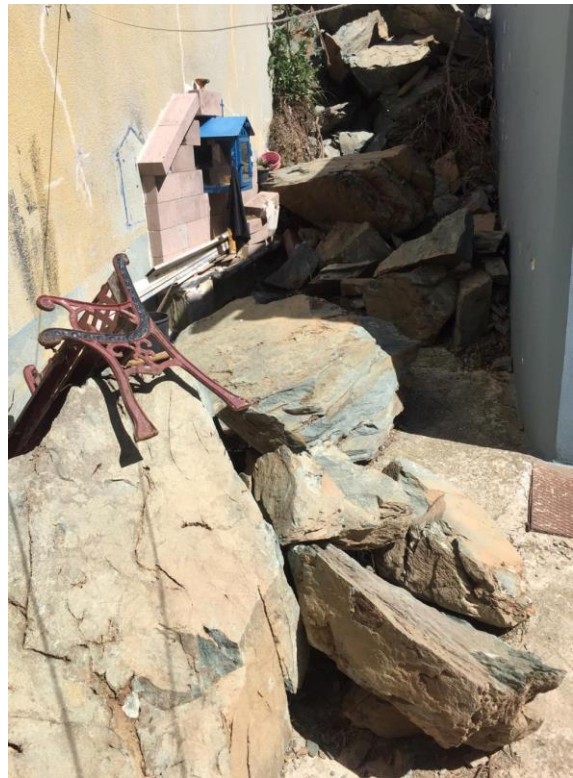
Εικόνα 3: Πεσμένα τεμάχη στον δρόμο μπροστά από τα σπίτια. Φαίνεται ενδεικτικά ο όγκος τους σε σχέση με το παγκάκι.
