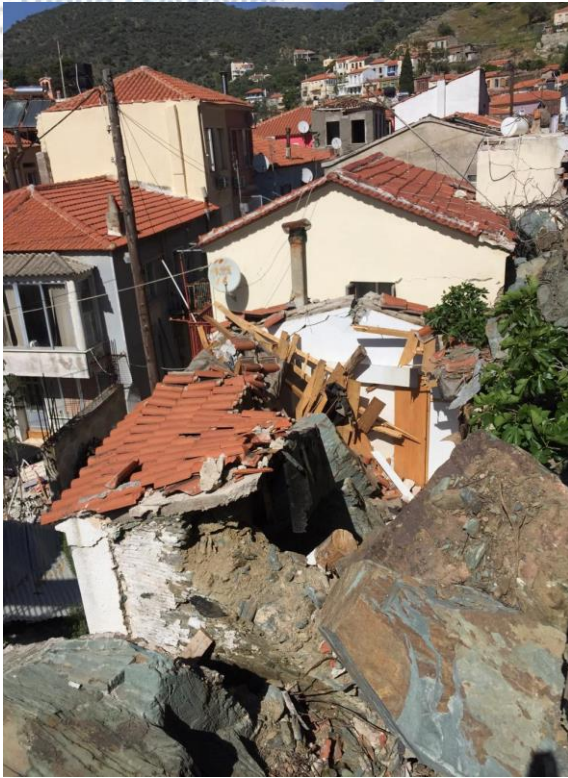
Εικόνα 2: Άποψη από την βάση του πρανούς. Διακρίνονται πεσμένα τεμάχη και σπίτι που υπέστη σοβαρές ζημιές.
