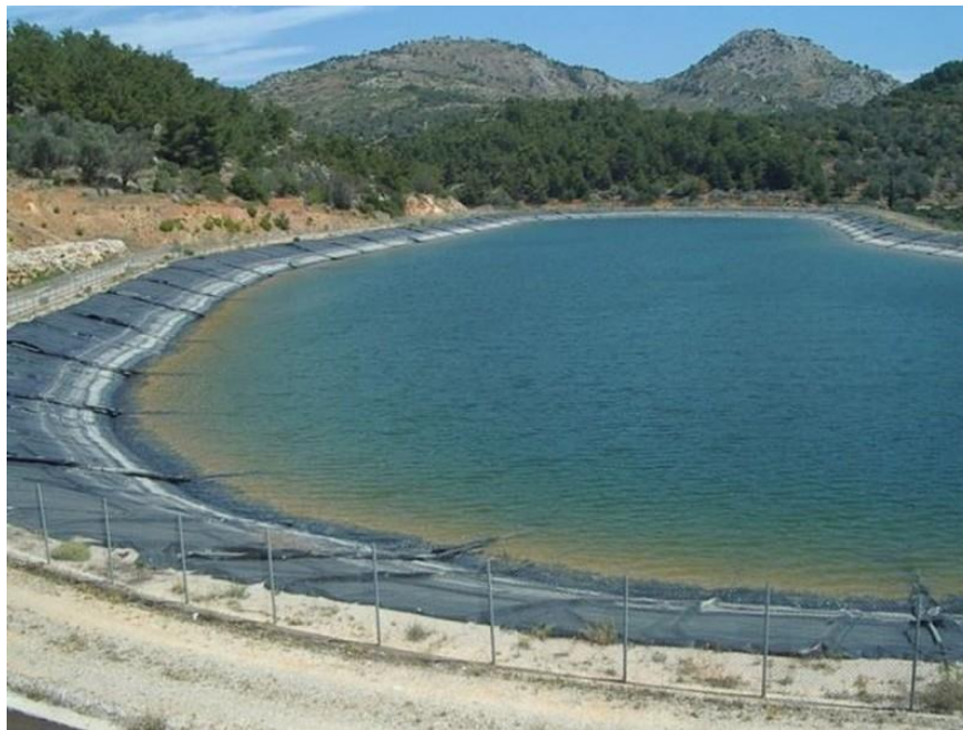
Σχήμα 6: Εμφάνιση της γεωμεμβράνης της λιμνοδεξαμενής από την πτώση στάθμης του νερού. (πηγή φωτογραφίας: epoli.gr )
