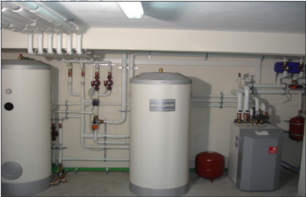
Εικόνα 3.2 Γεωθερμική αντλία θερμότητας
