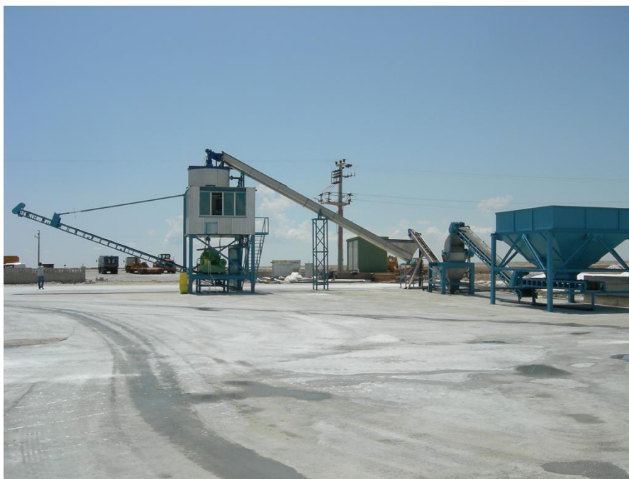
Σχ. 3.1. Εγκατάσταση πλυντηρίου αλατιού ( www.saltwashing.com )
