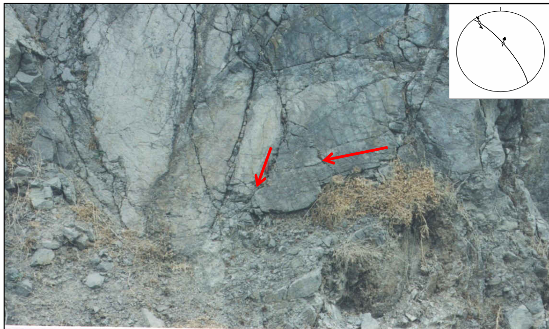
Φωτ. 10. Ρηξιγενή επιφάνεια διεύθυνσης ΒΒΔ-ΝΝΑ με αποτυπωμένες δύο γραμμώσεις ολίσθησης, Αρχαία Άντισσα
