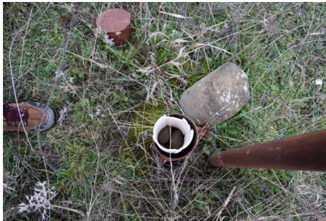
Εικόνα 7.1 Υφιστάμενη κατάσταση σωλήνων αποκλισιομέτρων εντός των γεωτρήσεων.
