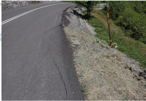
Εικόνα 7.5 Ρωγμές και αστοχίες επί του οδοστρώματος από την δράση κατολισθητικών φαινομένων και καθιζήσεων, σε περιοχή εντός της κύριας κατολίσθησης, επί του παλαιού δικτύου Λαμίας – Καρπενησίου.
