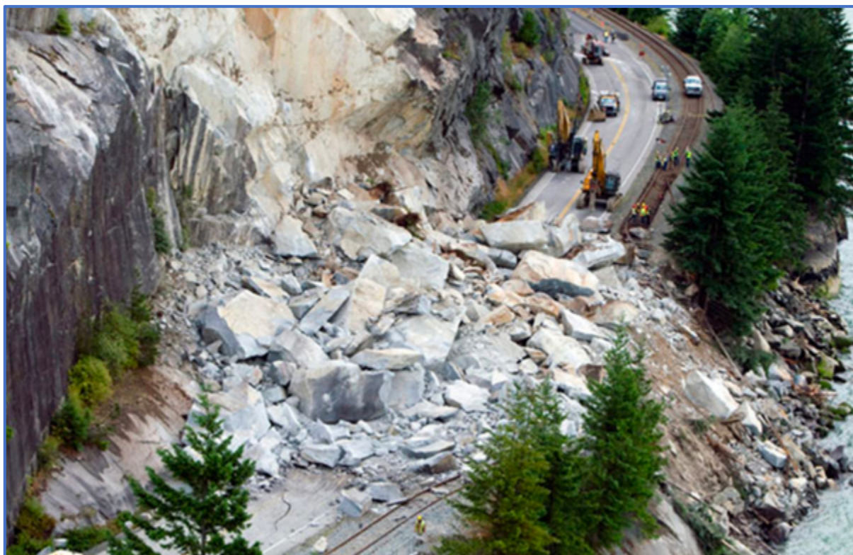
Εικόνα 3. Τυπική εικόνα εκτεταμένης βραχοκατάπτωσης από θέση του αυτοκινητόδρομου Sea to Sky στο Καναδά (τύπος Καναδά).
