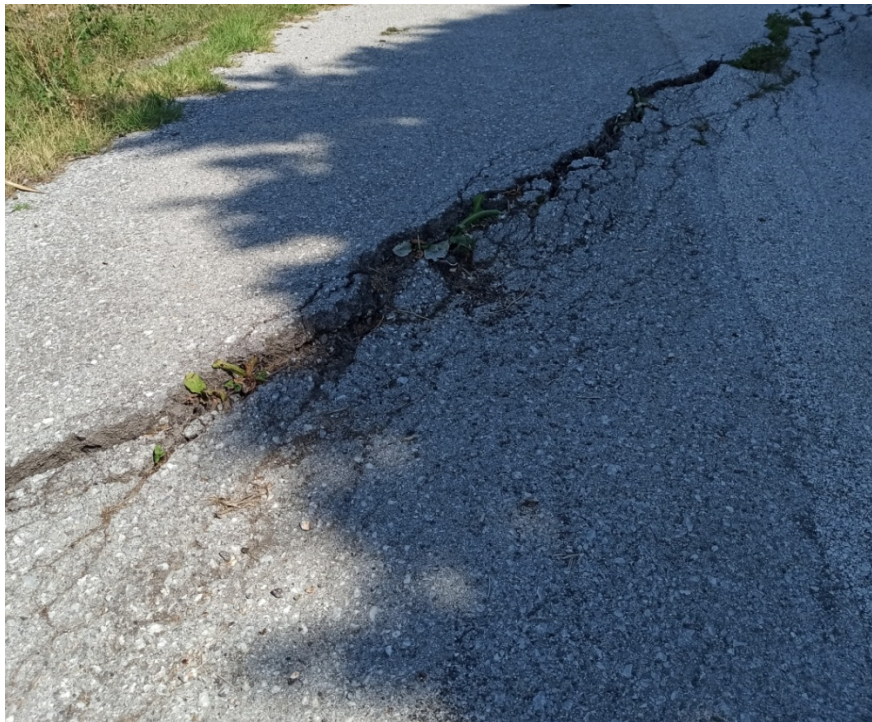
Φωτογραφία 14. Ρώγμωση στον δρόμο, οικισμός Ανάργυροι.
