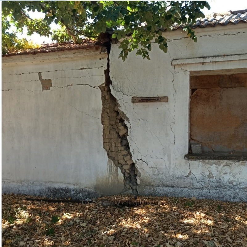
Φωτογραφία 13. Ρωγμώσεις σε οικία, Βαλτόνερα.
