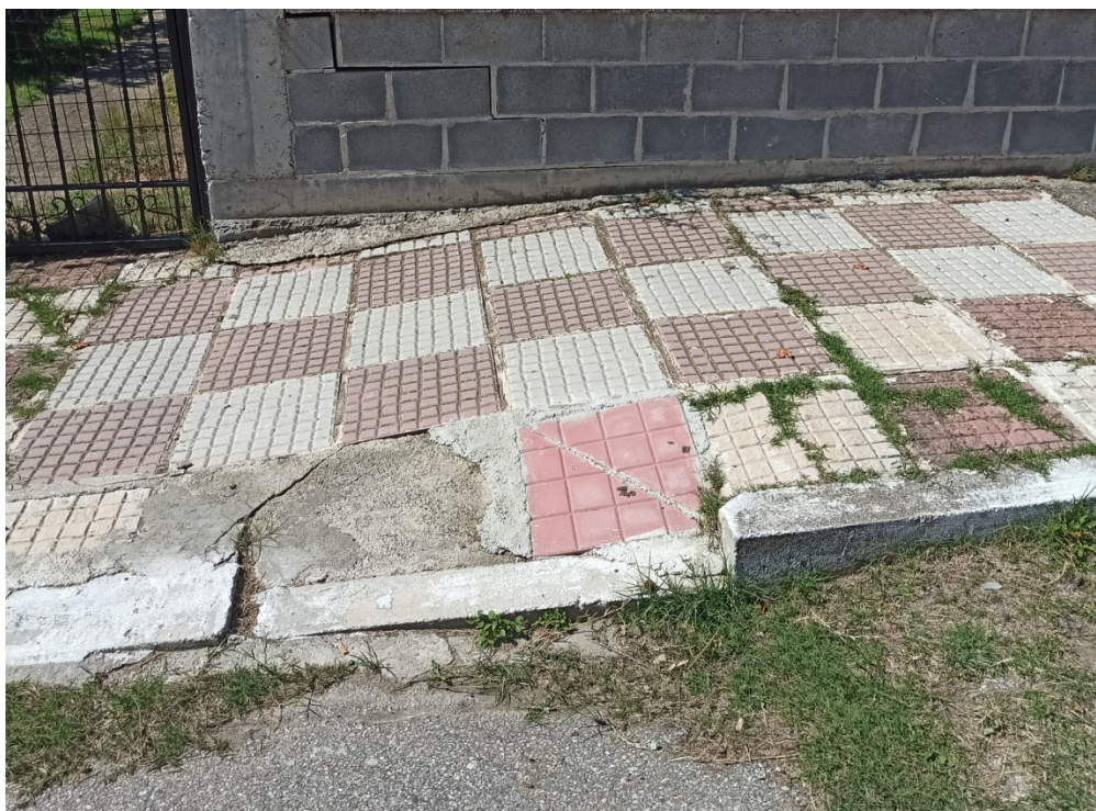
Φωτογραφία 10. Ρωγμές σε πεζοδρόμιο, Βαλτόνερα
