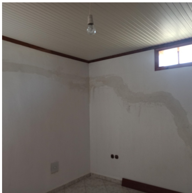
Φωτογραφία 2. Επιδιορθωμένες ρωγμές σε οικία στον οικισμό Βαλτόνερα.
