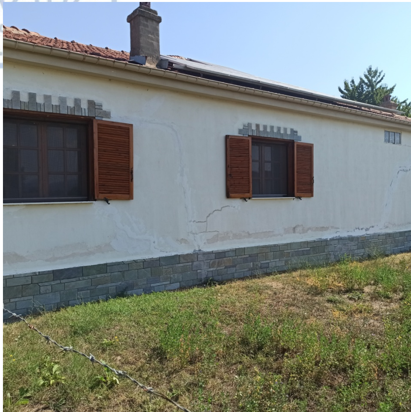
Φωτογραφία 5. Επισκευασμένες ρωγμές σε εξωτερικό οικίας, Βαλτόνερα
