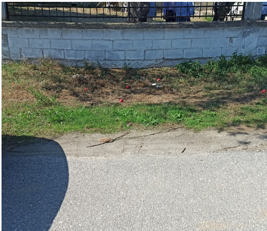
Φωτογραφία 6. Εδαφική καθίζηση στον οικισμό Βαλτόνερα.
