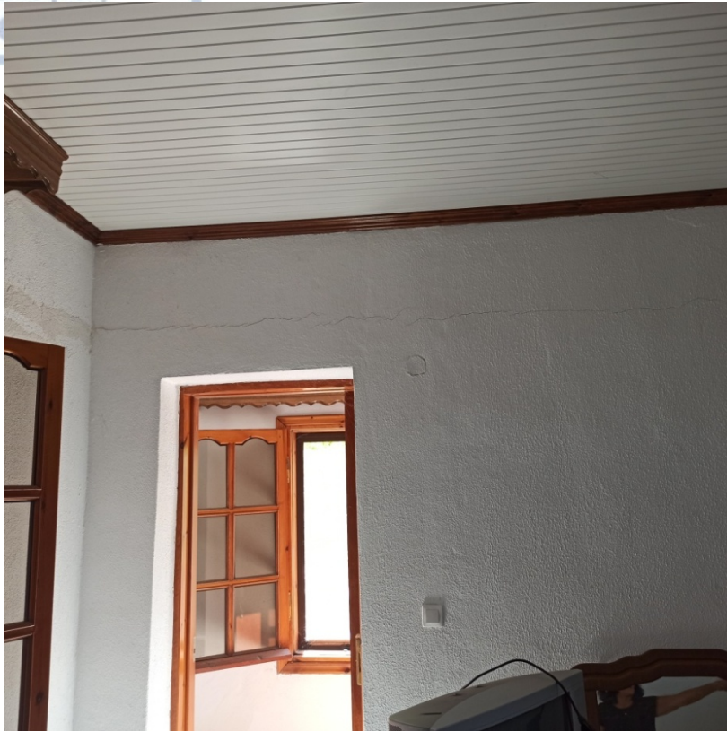
Φωτογραφία 3. Ρωγμές σε οικία στον οικισμό Βαλτόνερα.
