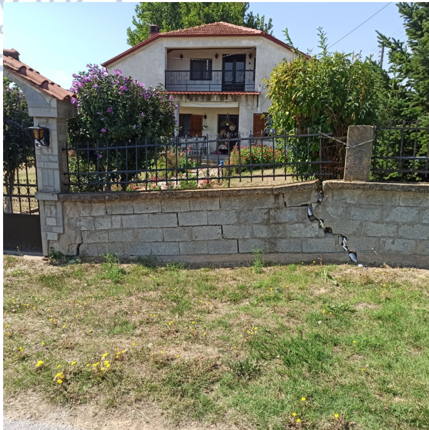
Φωτογραφία 7. Ρώγμωση σε εξωτερικό τοίχο σε οικία, Βαλτόνερα.
