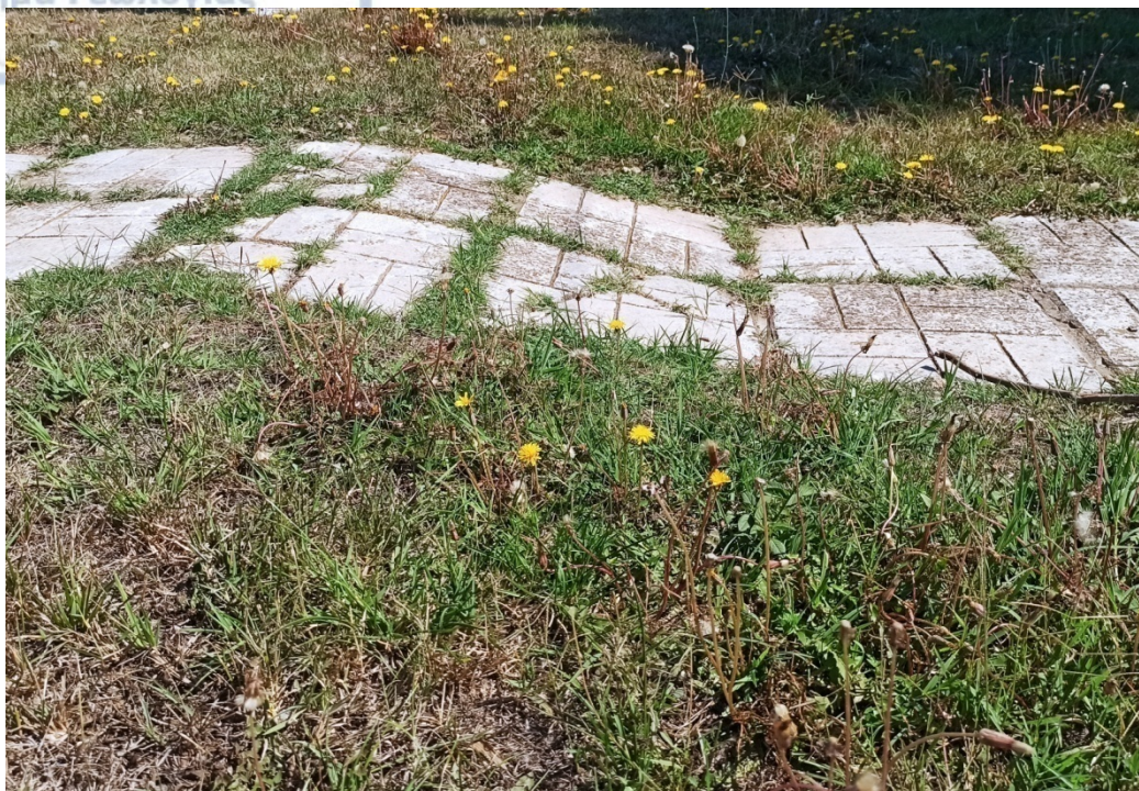
Φωτογραφία 9. Εδαφική καθίζηση στον οικισμό Βαλτόνερα.
