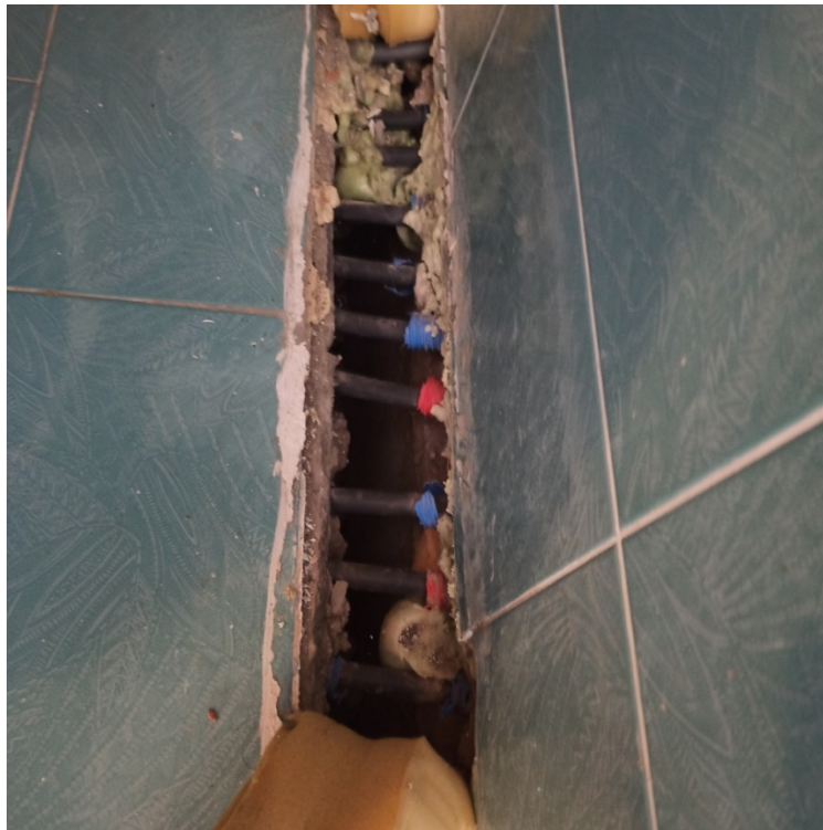
Φωτογραφία 4. Αποκόλληση πατώματος και ζημιές σε σωληνώσεις οικίας, Βαλτόνερα.
