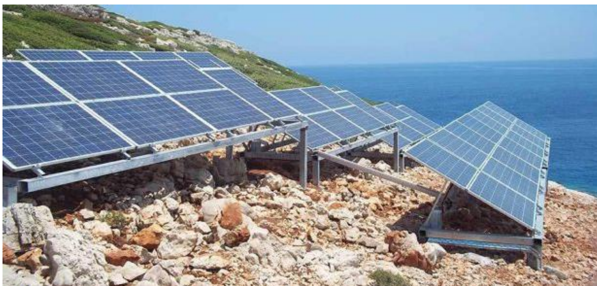
Εικόνα 25. Φωτοβολταϊκά πάνελ για τη λειτουργία της μονάδας αφαλάτωσης στην Στρογγύλη με τη συμβολή της ηλιακής ενέργειας. (Πηγή: energypress. (2018. 09.10), Ανάκτηση από https://energypress.gr/news/egkainiastike-monada-afalatosis-poy-leitoyrgei-apokleistika-meliaki-energeia ).
