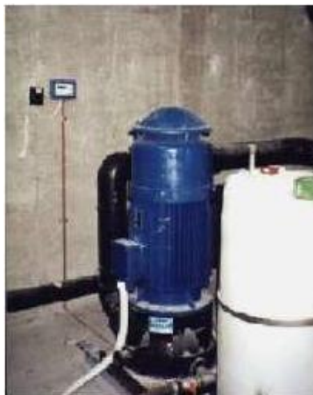
Εικόνα 29. Στη μονάδα αφαλάτωσης στην Κίμωλο η αντλία του γεωθερμικού συστήματος. (Πηγή: Υφαντίδης, 2014).
