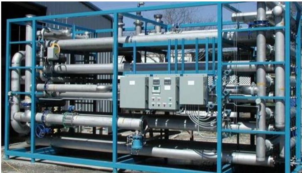
Εικόνα 32. Η τελευταία μονάδα αφαλάτωσης της Τήνου που τέθηκε σε λειτουργία το 2014. (Πηγή: ENERGIA.gr.)
