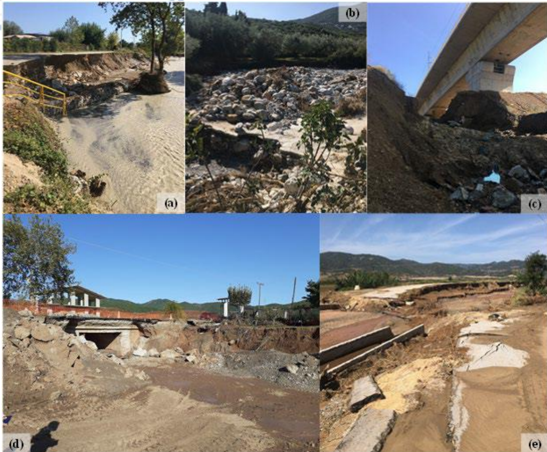
Εικόνα 8: Επιπτώσεις τις κακοκαιρίας Ιανός στην ευρύτερη περιοχή της Λαμίας: α) Διαβρωμένη όχθη και κατεστραμμένο επίχωμα του δρόμου, β) Το φαινόμενο της στερεοπαροχής, γ) Διαβρωμένα θεμέλια της σιδηροδρομικής γέφυρας βόρεια της Στίρφακας, δ) Διαβρωμένη όχθη ποταμού, ε) Κατεστραμμένο επίχωμα δρόμου παράλληλου στην Εθνική Οδό Λαμίας – Καρπενησίου (Zekkos et al. , 2020).
