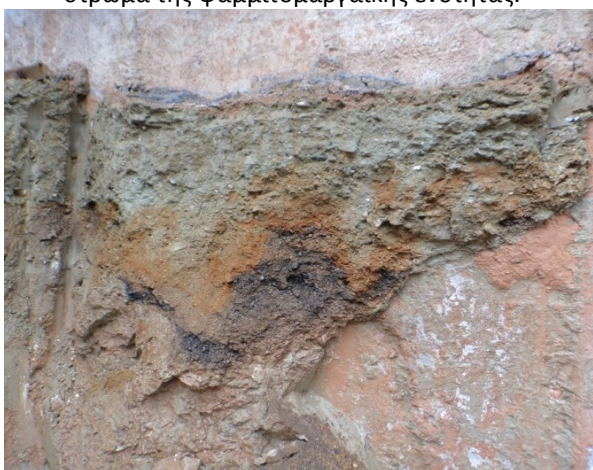
Σε κάθετη τομή σε πρηνές εκσκαφής διακρίνεται η παρουσία παλαιοεδάφους (τεφρό χρώμα) σε υλικό πλήρωσης ελαιοπράσινο έως καστανό της επιφάνειας ολίσθησης
