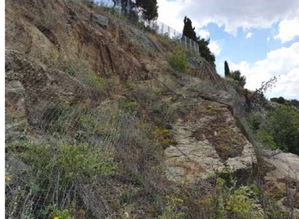
Μεταλλικό δίκτυο για τη αποφυγή καταπτώσεων μέσα στην κατοικημένη περιοχή
