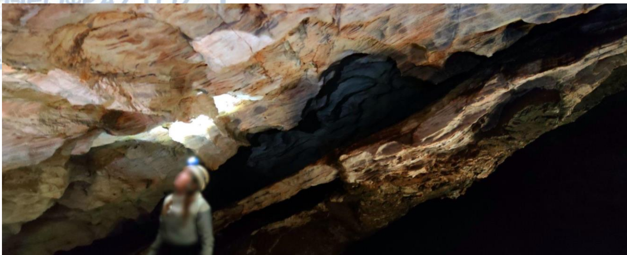
Εικόνα 12. Υπόλειμμα όγκου πετρώματος μετά από κατάρρευση τμήματος του στο κέντρο του κύριου θαλάμου. Η διάλυση ανάμεσα σε αυτόν τον όγκο που παρέμεινε στη θέση του και στην οροφή, προηγείται της κατάρρευσης (Φωτ. Καράμπελας Α. ).
