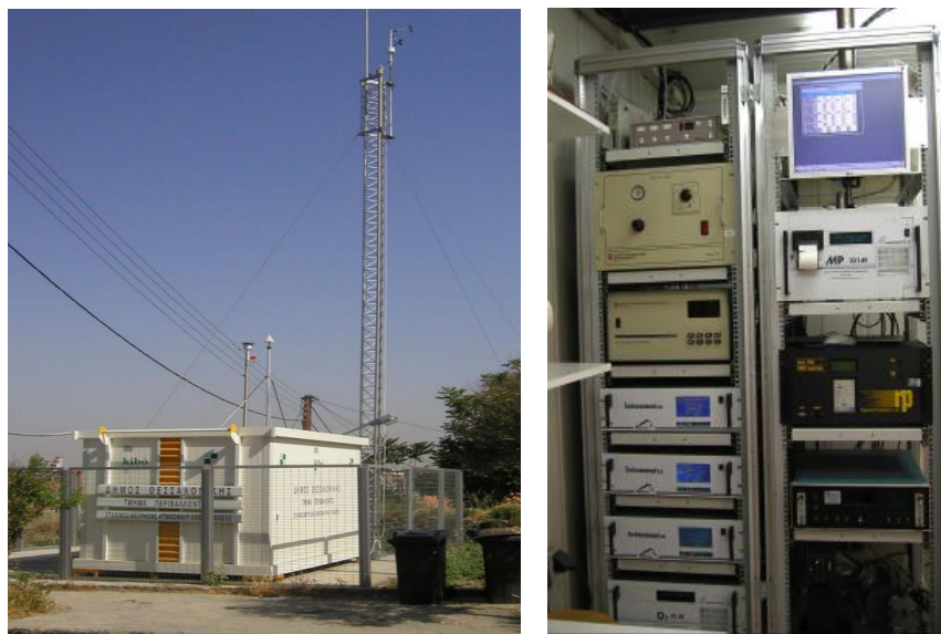
Εικόνα 24. (α) Ο αστικός σταθμός υποβάθρου του Επταπυργίου, στην Άνω Πόλη, του Δικτύου Μέτρησης Ατμοσφαιρικής Ρύπανσης, του Δήμου Θεσσαλονίκης. (β) Εσωτερικό Σταθμού Μέτρησης Ατμοσφαιρικής Ρύπανσης, του Δήμου Θεσσαλονίκης.
