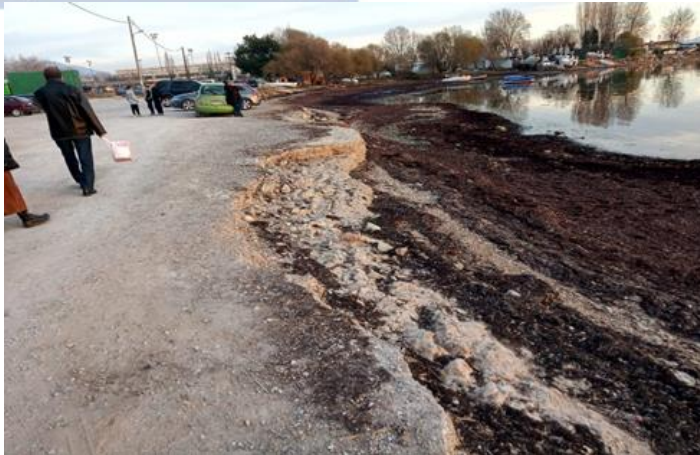
Εικόνα 3.47 Απεικόνιση της διάβρωσης του εδάφους στη Ν. Κρήνη στην οδό Θέτιδος (URL9)
