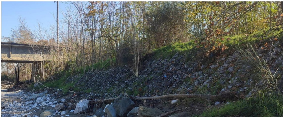
Σχήμα 42. Φωτογραφίες από τα πλευρικά τοιχώματα της κοίτης του Πάμισου όπου παρατηρούνται οι ζημιές τόσο στο ριζικό σύστημα όσο και στο συρματοκιβώτιο.
