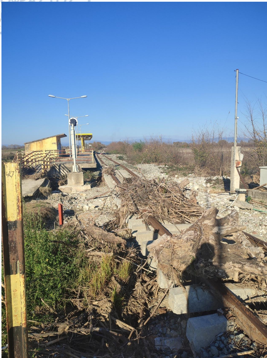
Σχήμα 62. Εικόνα από το σιδηροδρομικό σταθμό Μαγούλας λίγο έξω από το ομώνυμο χωριό. Παρατηρείται η εκτεταμένη καταστροφή λόγω της ορμής που είχε το νερό.
