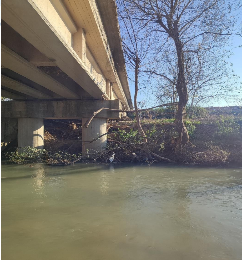
Σχήμα 48. Φωτογραφία από την κατάσταση στα πλευρικά τοιχώματα της κοίτης όπου κορμοί δέντρων έχουν αποκοπεί λόγω του βίαιου περάσματος του νερού.
