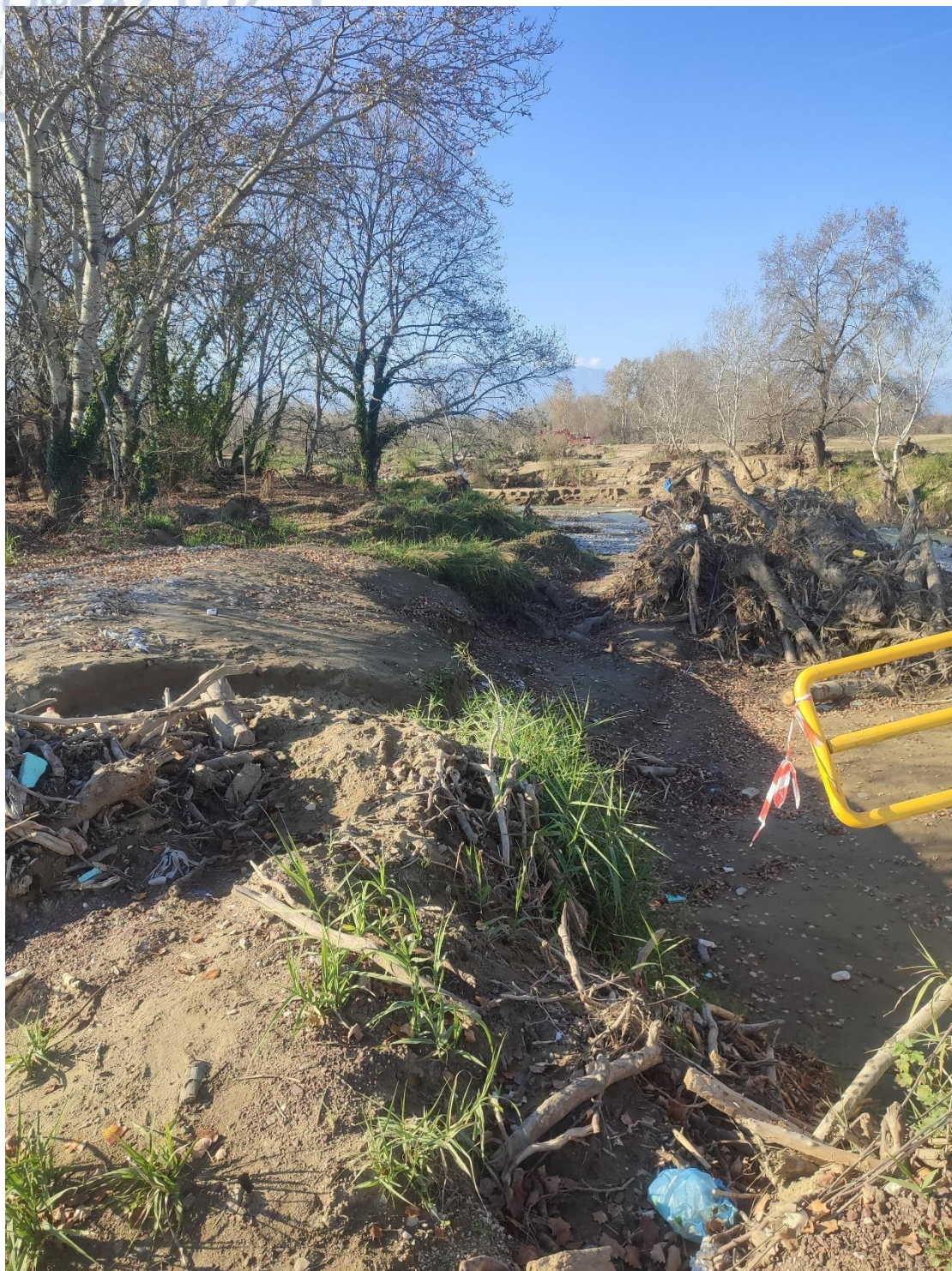
Σχήμα 45. Σημείο πλευρικού αναχώματος στο όριο της κοίτης του ποταμού από το οποίο φαίνεται να πέρασε το νερό κατευθυνόμενο προς τα χωράφια στα νότια της.
