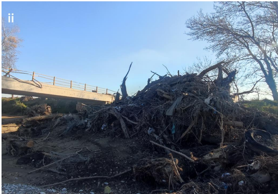
Σχήμα 43. Φωτογραφίες από τη Θ4. i) Φωτογραφία πάνω στη γέφυρα. Παρατηρούνται τα κατεστραμμένα κιγκλιδώματα. ii) Φωτογραφία κάτω από τη γέφυρα. Παρατηρείται η μεγάλη μάζα από κορμούς δέντρων, ρίζες δέντρων και ό,τι άλλο βρέθηκε στην πορεία του νερού και αποτέθηκαν εδώ.
