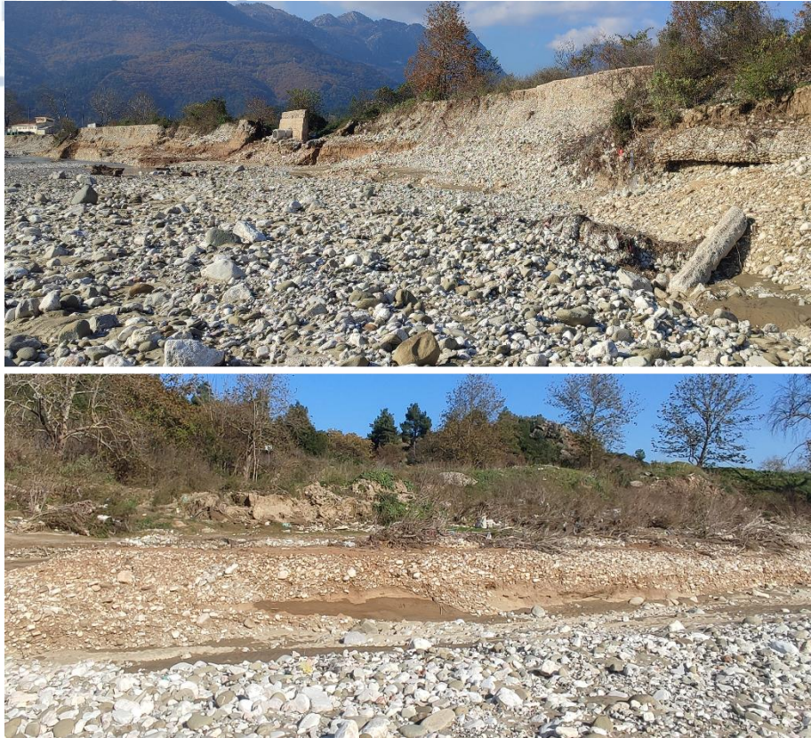
Σχήμα 39. Φωτογραφίες των πλευρικών τοιχωμάτων της κοίτης. Παρατηρείται τόσο η απουσία συνοχής στη βλάστηση, όσο και τα κατεστραμμένα πλευρικά τοιχώματα, όλα αποτέλεσμα του σφοδρού περάσματος της πλημμύρας.
