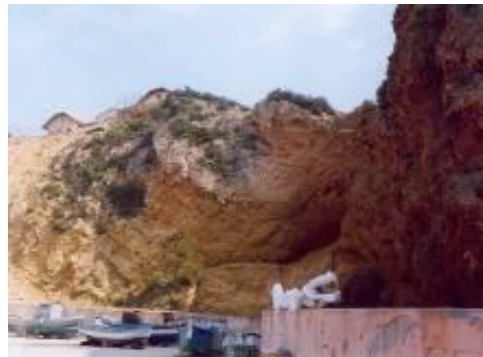
Σχήμα 5. Διακρίνεται η είσοδος εγκοίλου που εντοπίζεται στο βορειοδυτικό πρανές της χερσονήσου που φιλοξενεί το "Παλατάκι". Το σπήλαιο αυτό βρίσκεται στο τέλος της 2ης φάσης της διαδικασίας γένεσης. Τα υλικά που αποκολλήθηκαν από την οροφή έχουν διαβρωθεί αλλά η κατασκευή του λιμενοβραχίονα απέτρεψε την περαιτέρω σε βάθος επέκταση του εγκοίλου.
