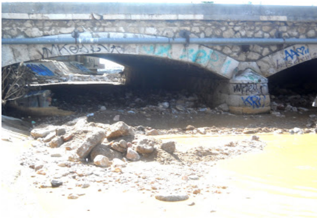
Εικόνα 7: Φερτές ύλες που συγκεντρώθηκαν στο Ιλισσό με τη βροχόπτωση της 22 ας Φεβρουαρίου 2013. Πηγή: http://my-mosxato.blogspot.gr/2013/02/photos-video.html
